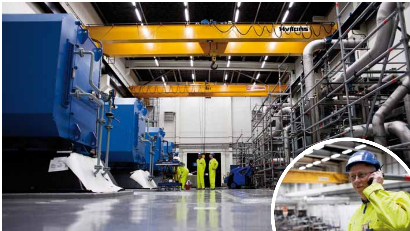
Till vänster syns kylvattenpumparna som tar sitt vatten från Östersjön.
